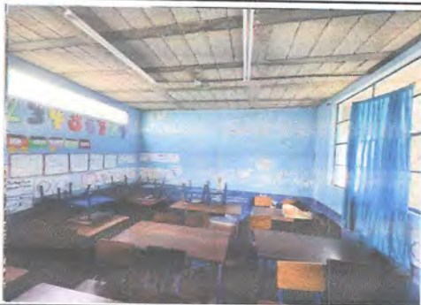
Foto 3: Modulo 1, Muro con humedad, es necesario aplicar impermeabilizante
