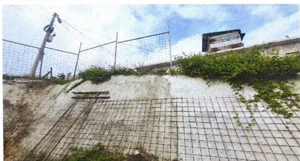
Foto 1: MURITO DE CONTENCIÓN
