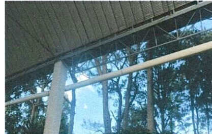
Foto 2: tubería de agua de la cancha
