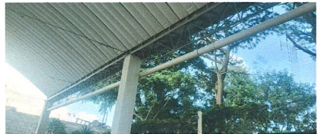
Foto 4: tubería de agua de la cancha
