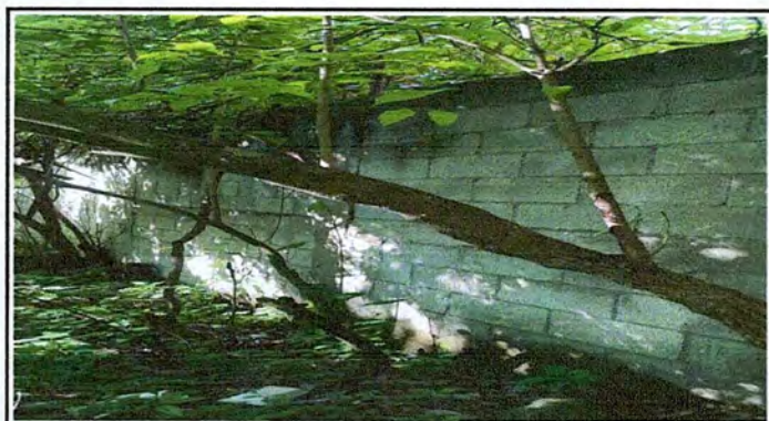
Foto: 3) pared que se continuará el alto con 7 hiladas con el objetivo de evitar que se ingresen los ladrones.
