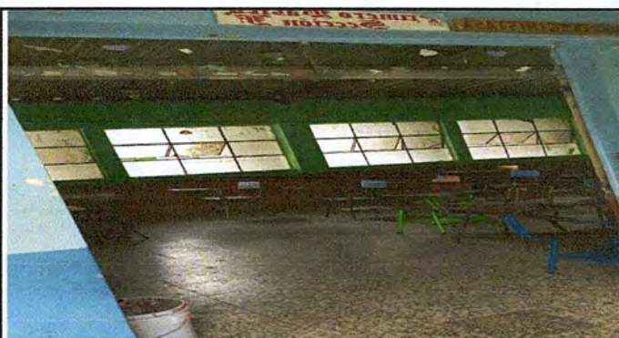
Foto: 6) aula sin puerta por robo
