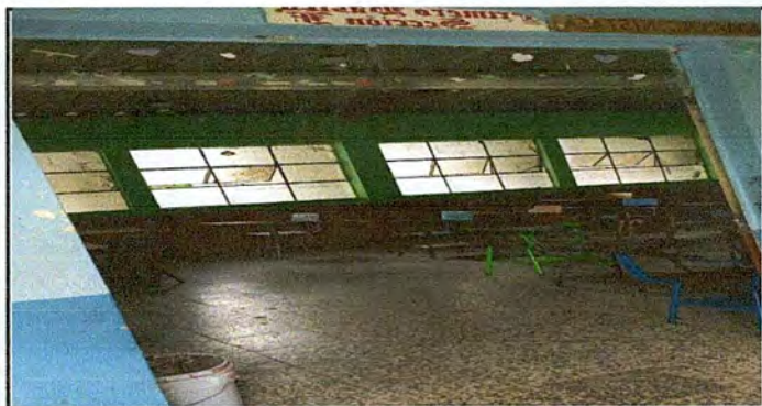
Foto: 6) aula sin puerta por robo
