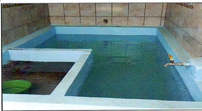
Foto 5:. Cisterna para recolección de agua potable
