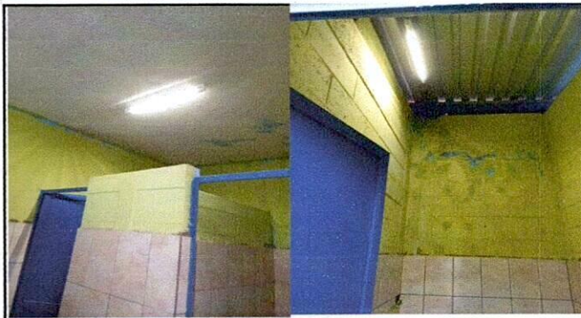
Foto 2:. Mejoras en sistema eléctrico
