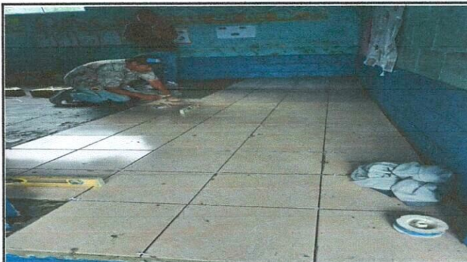
Foto 4:. Piso en aulas
