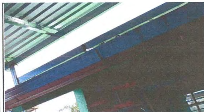
estructura mas fuerte para el soporte del
