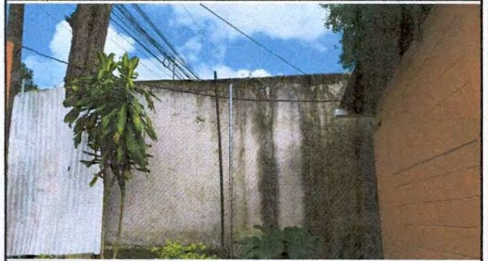
Foto 4: Pintura, malla lateral derecho escuela.
