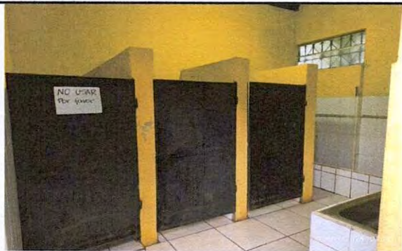
Foto1: Baño de niños previo a su remozamiento
