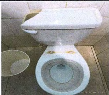
Foto 1: Sanitario a cambiar de baño de niñas
