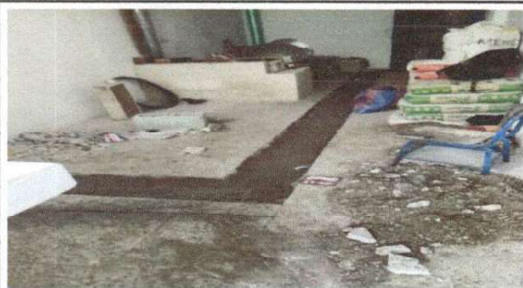
Foto 1: Sanjeo, tubería para drenaje.
