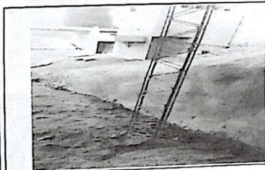
Foto 3: TERRAPLEN CERCA DEL PATIO
