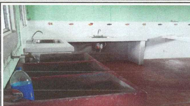
Foto 2: Cocina con una pila de 2 lavaderos y dos lavatrastos.
