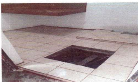
Foto 1: Cernido de paredes de bodega de cocina
