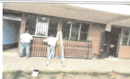
Foto 2: Módulo No. 1 debido al tema de seguridad y que el establecimiento carece de muro perimetral seguro es necesario la colocación de balcones en todas la ventanas de la escuela.
