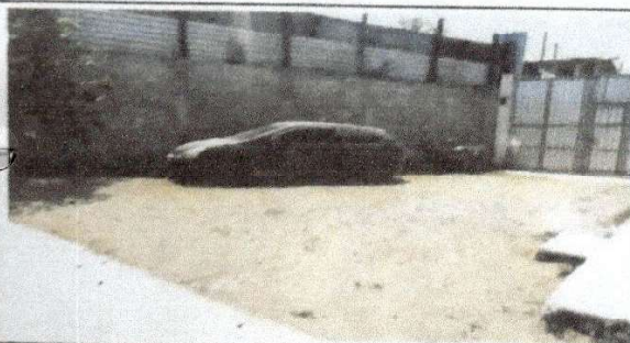
Foto 5: Módulo No. 1: El portón de ingreso a la escuela necesita mantenimiento.
