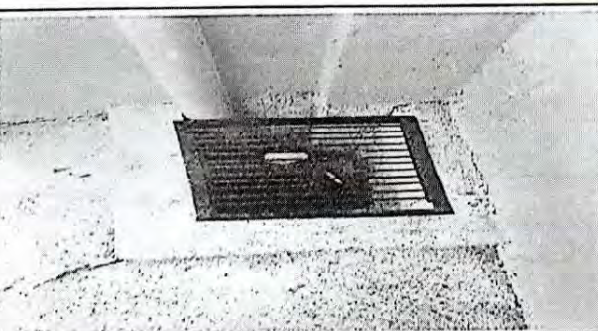
Foto 5: Rejilla en caja de unión de agua pluvial.
