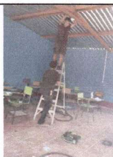
Foto 4: instalación eléctrica, en aulas y exterior.
