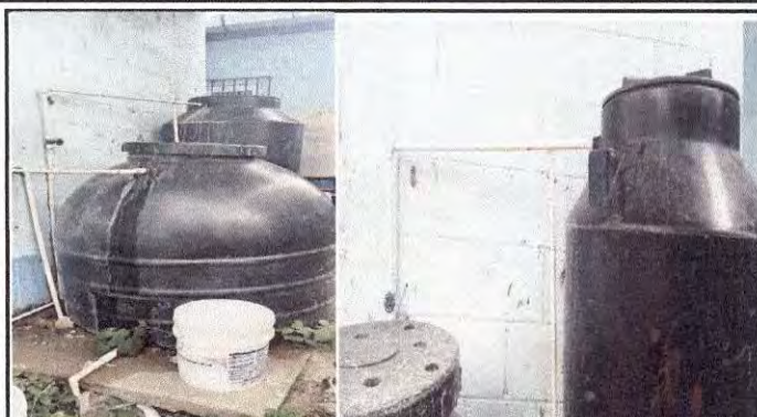
Foto 14: Red de agua potable en tinacos
