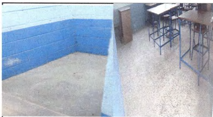
Foto 3: Sustrucción de piso de granito
