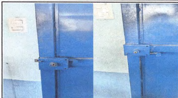
Foto 1: Sustrucción de chapas
