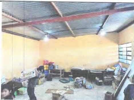
Foto 3: Salones de clases sin piso.
