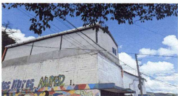
Foto 1: fachada del centro educativo, pared de tabla roca nivel 3, cernido en pared de block del nivel 3
