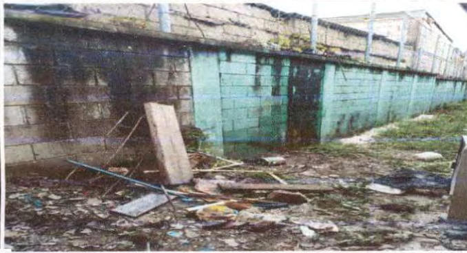
Foto 1: Deterioro de pared por lluvia.
