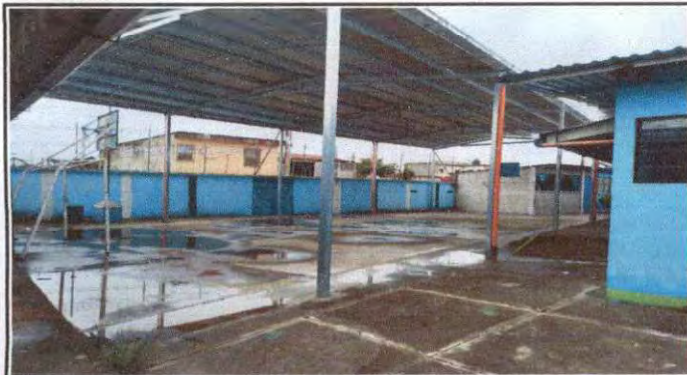
Foto 1: Necesidad cambio losa de patio
