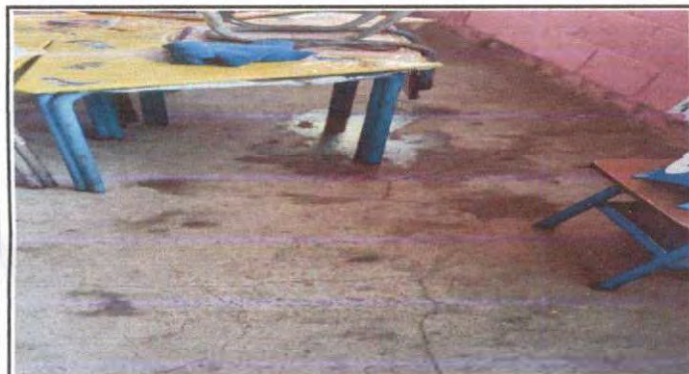
Foto 3: GRIETAS EN PISO AULA 1
