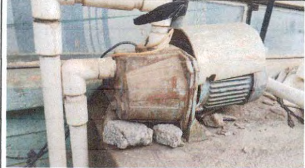
Foto2: Deterioro de la bomba.
