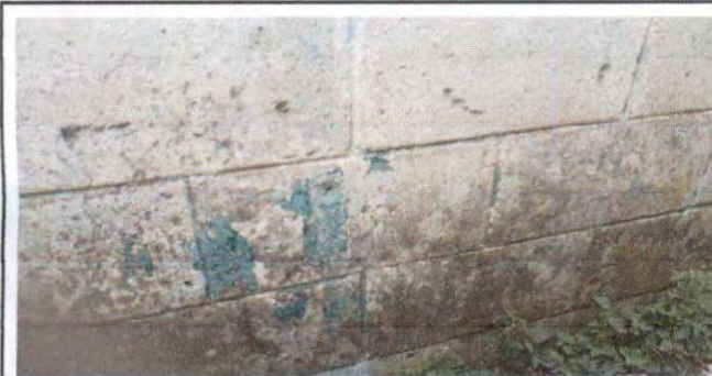
Foto 3: Deterioro pintura exterior.
