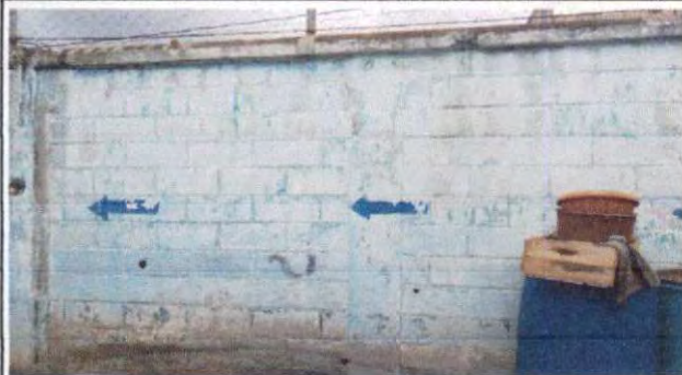
Foto1: Deterioro pintura interior.
