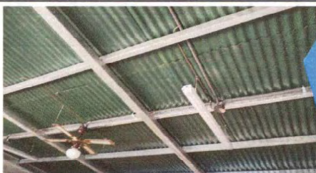
Foto2: Acumulación de calor por el tipo de lámina.
