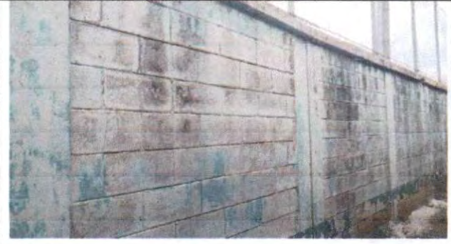
Foto2: Deterioro pintura Interior.
