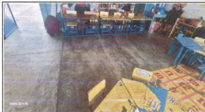
Foto 2: DETERIORO DEL PISO POR ANTIGUEDAD (20 AÑOS)
