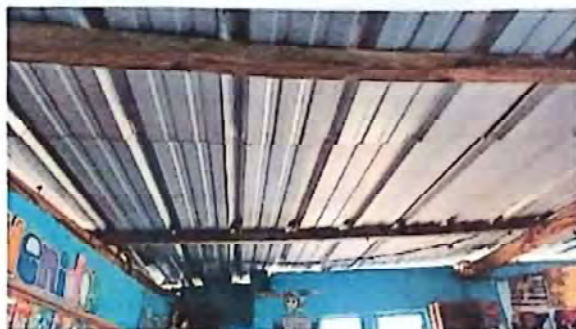
Foto 8: Derivado al mal estado del techo, se sustituye en dos aulas. En el segundo piso.
