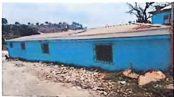
Foto 7: Derivado a la filtración del agua en las aberturas, se hará la impermeabilización en el techo.
