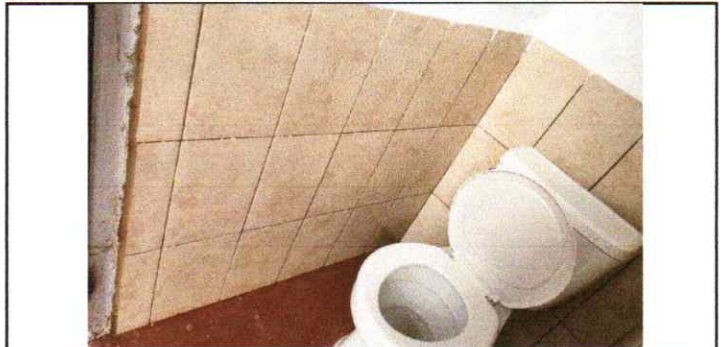
Foto 4: Azulejo en sanitarios
