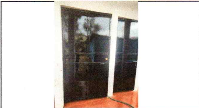
Foto 3: Puertas de metal para ingreso de sanitarios
