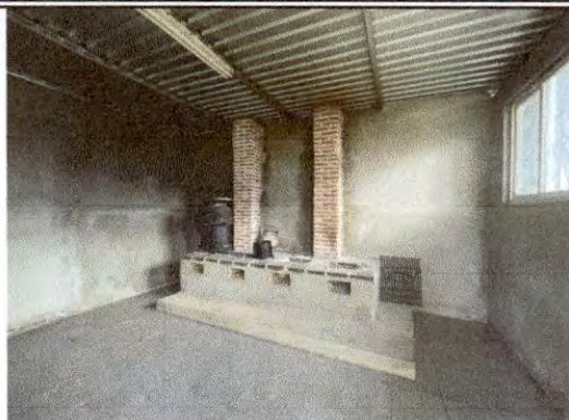
Foto 2: Módulo B, paredes sin tratar
