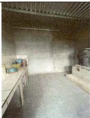
Foto 3: Módulo B, muros en cocina sin tratar
