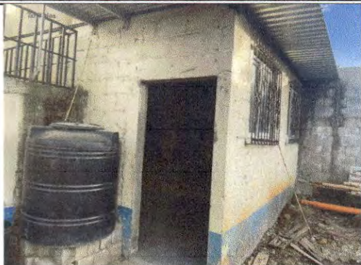
Foto 1: Módulo B, muros deteriorados
