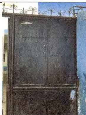
Foto 10: Módulo C, portón deteriorado con corrosión
