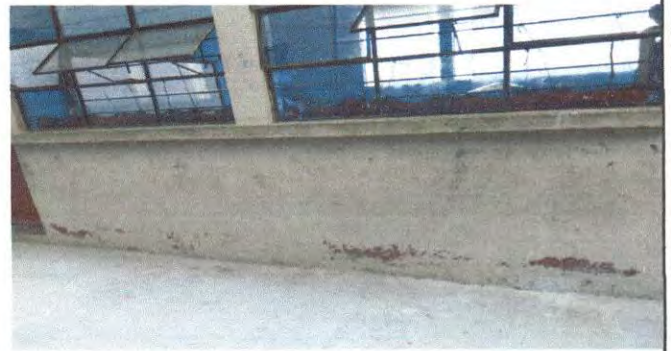
Foto 16: Paredes de aulas de exterior que necesitan pintura.
