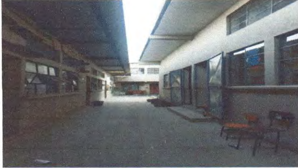
Foto 13: Pasillo de la planta baja que necesita pintura.
