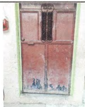
Foto 8: Puerta de la cocina está muy deteriorada.
