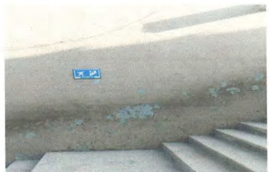
Foto 14: Pared de las gradas de acceso a la planta baja del establecimiento la cual también evidencia deterioro de la pintura.
