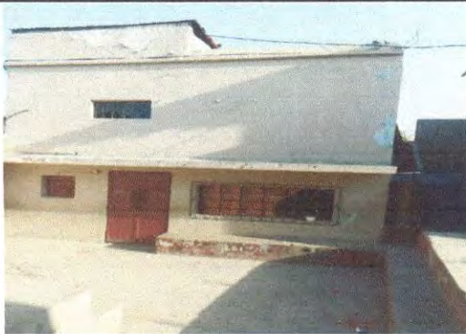
Foto 15: Área de la planta alta del establecimiento en la cual necesita pintura.
