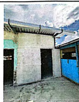
Foto 10: Levantado de muro en cocina.
