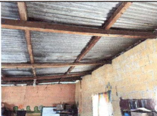
Foto 1: La estructura actual del techo en el salón es de madera, la cual presenta daños por plagas y se encuentra pandeada debido a las altas temperaturas.
