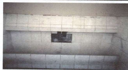
Foto 6: Así quedó el mingitorio, funciona bien, no presenta fuga de agua.
