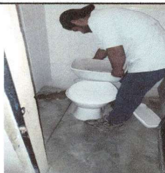
Foto 4: Módulo 5, Acá se puede observar el cambio de Kits de sanitarios
