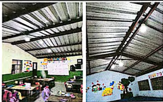
Foto 3: Instalación eléctrica de iluminación y fuerza.
