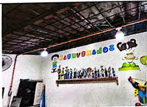
Foto 5: Instalación eléctrica en Dirección
