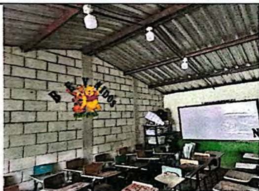
Foto 3: Se deberá realizar el cambio del cableado en el sistema eléctrico del módulo B.
