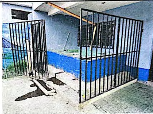
Foto 8: La rejilla que protege la pila se encuentra dañada por la oxidación, por lo que se deberá sustituir.
