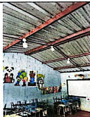
Foto 4: Las lámparas se queman de manera constante debido a problemas en el sistema eléctrico en el módulo B.
