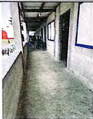
Foto 7: Al igual que en los salones se propone colocar piso en el pasillo que cubre el frente de dichos salones en el módulo C
