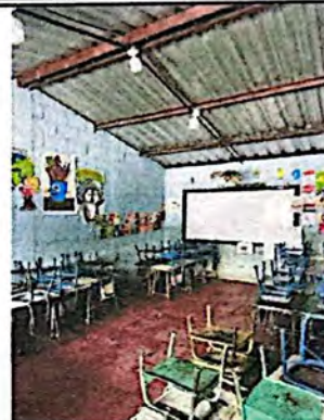
Foto 2: En el módulo B el piso que tienen alguno de los salones presenta daños debido a la antigüedad que tienen.
