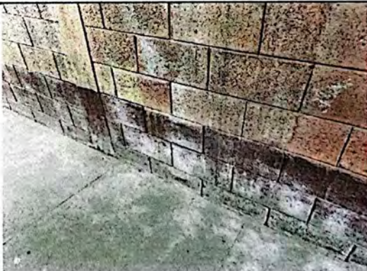
Foto 10: El Muro de la Bodega se encuentra sin mantenimiento, por lo que presenta moho.
