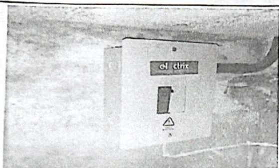
Foto 9: cableado y flipon para funcionamiento de bomba de agua
