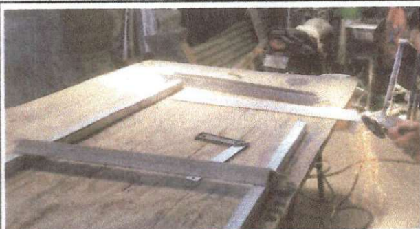
Foto 3: Ventanales de metal para sanitarios de niños pequeños.
