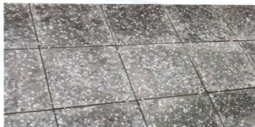
Foto 5: piso de granito en bodega 1
