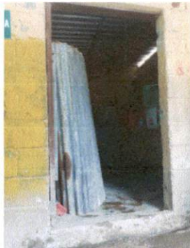
Foto 13: La puerta de lámina de la bodega pegada a la cocina necesita sustituirse por una puerta metálica con chapa.
