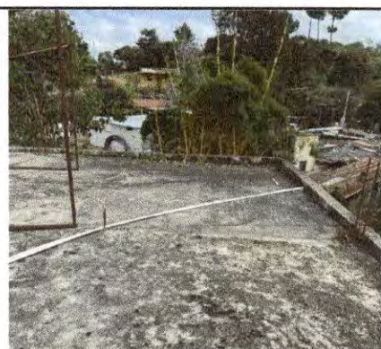
Foto 10: Módulo A, losa deteriorada
