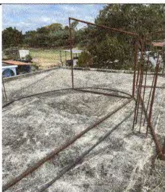
Foto 9: Módulo A, losa en mal estado
