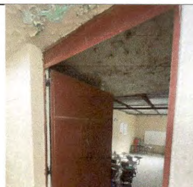
Foto 6: Módulo A, techo en mal estado
