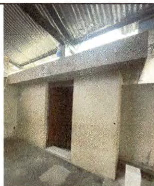
Foto 5: Módulo A, paredes deterioradas
