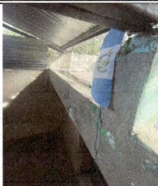
Foto 1: Módulo A, láminas en mal estado que permiten filtraciones
