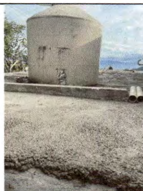
Foto 4: Módulo A, losa en mal estado
