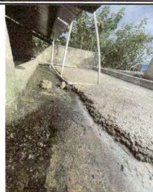
Foto 2: Módulo A, losa en mal estado
