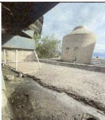
Foto 3: Módulo A, losa con filtración
