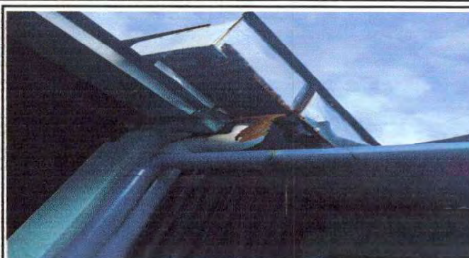
Foto 2: Canal de aula de quinto grado en mal estado
