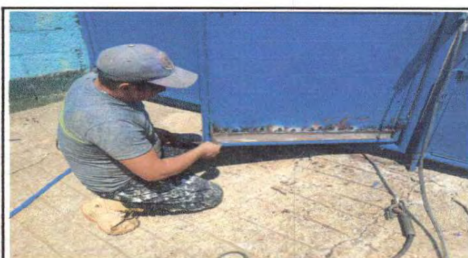
Foto 4: Sustitución de parte corroída por oxido del porton
