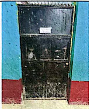
Foto 7: Las puertas presentan oxidación y se encuentran sucias, por lo que se deberá realizar el mantenimiento.
