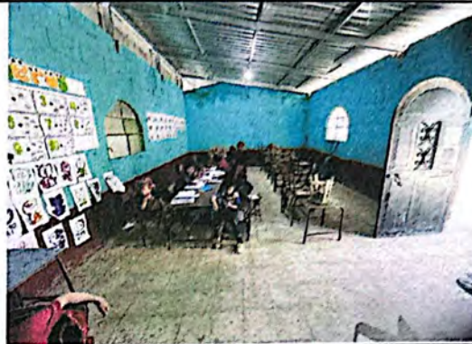
Foto 2: El cambio de piso es necesario, tomando en cuenta los años de uso que tiene actualmente.
