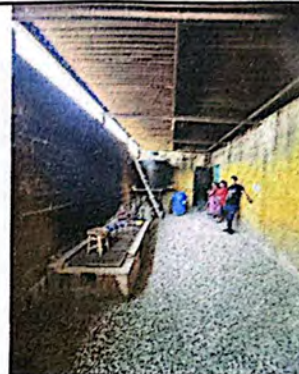
Foto 8: Se deberá realizar el mantenimiento a la estructura del techo.
