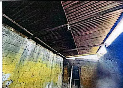
Foto 10: Se deberá realizar el cambio de la lámina en cocina debido a la cantidad de óxido que presenta la lámina actual.
