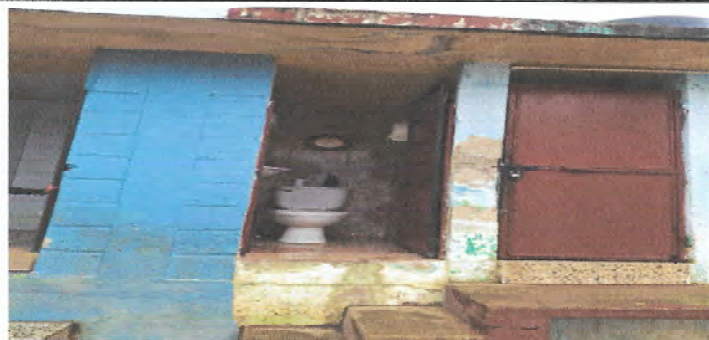
Foto 7: Sanitario a remodelar
