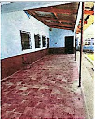
Foto 3: También se deberá realizar el cambio de piso en el área de pasillo, tomando en cuenta que es el espacio en el que los niños utilizan para jugar.
