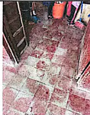
Foto 2: Se puede apreciar el daño que ha sufrido el piso debido al uso a lo largo de los años.
