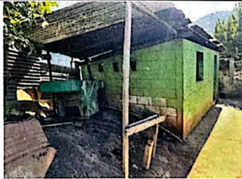
Foto 6: Será necesario realizar mejoras en el área de cocina, considerando que por la oxidación el techo se está destruyendo.
