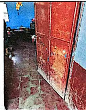
Foto 4: Es pertinente realizar el mantenimiento a las puertas, incluyendo el lijado y pintura.
