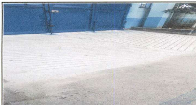
Foto 3: Sustrución de gradas por rampa de losa.
