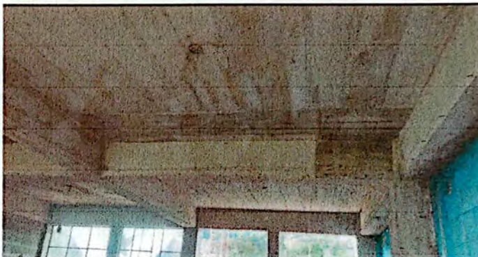
Foto 11: Se necesita la terminación del repello y cernido de paredes...
