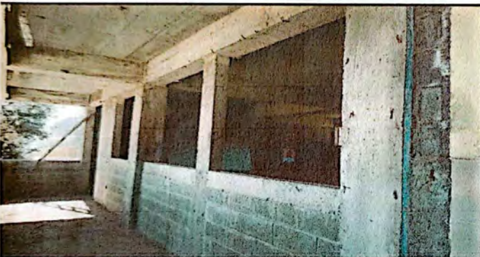
Foto 10: El salón necesita ventanales, terminación de la colocación de piso, ventanas, repello y cernido de paredes
