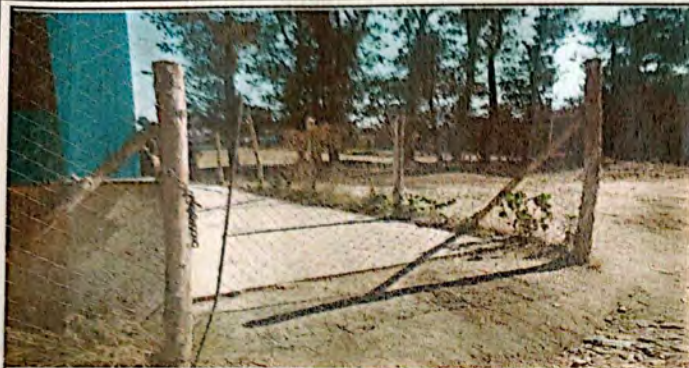
Foto 8: Así mismo conjunto a la construcción del muro perimetral del establecimiento, se necesita el mantenimiento o reestructuración de un portón de metal.
