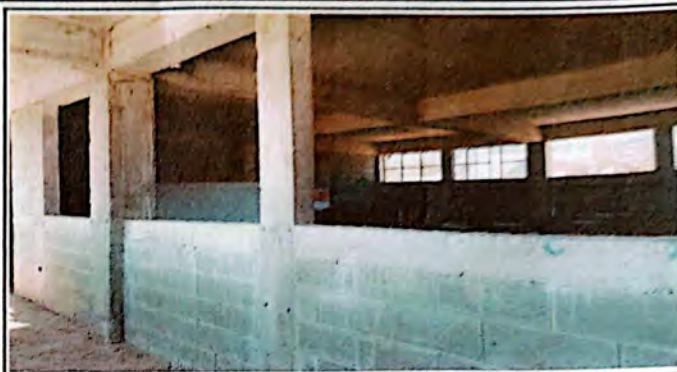
Foto 2: Esta imagen muestra el salón No. 9 del segundo nivel sin ventanas, anteriormente se colocó nylon, se hará sustitución de ventanas con nylon por estructuras de metal.
