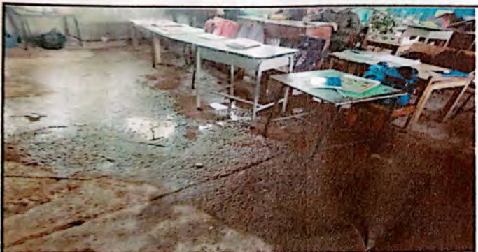
Foto 3: Esta imagen muestra el salón No. 9 del segundo nivel con torta de concreto, se sustituirá por piso cerámico.
