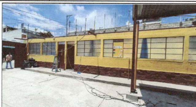
Foto 2: Área de techo de 4 salones que necesitan ser cambiados.
