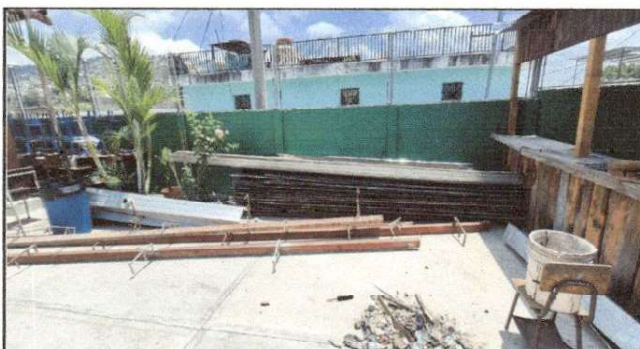
Foto 3: La mayor parte de la lámina ya esta deteriorada y al llover caen goteras
