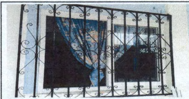
Foto 6. Ventanas de PVC corredizas para que se tenga mejor ventilación.
