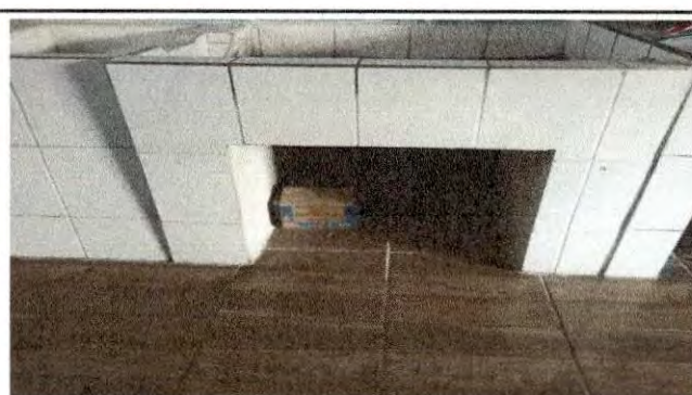
Foto 4. Pila de la cocina se amplió el lavadero del lado derecho y tapiado con azulejo
