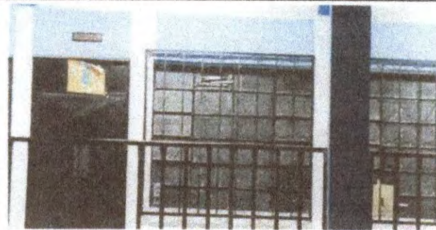
Foto 2 Las ventanas que no tienen como abrirse para que entre una adecuada ventilación, dentro de los salones de clase.
