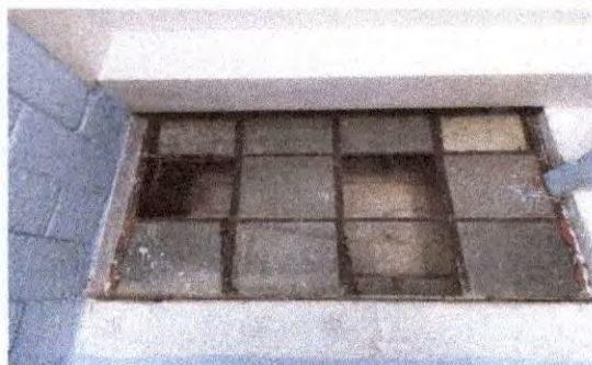
Foto 1. Ventana que se encuentra en el sanitario.
