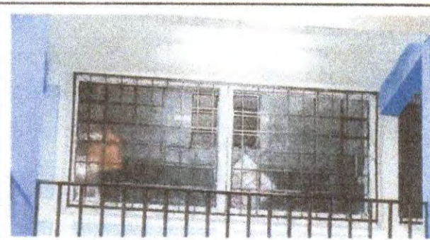
Foto 4. Constata de un buen tamaño, pero se necesita cambiar para que se puedan abrir.
