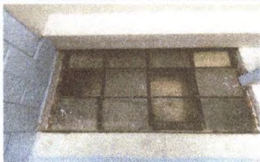
Foto 1 Ventana que se encuentra en el sanitario.
