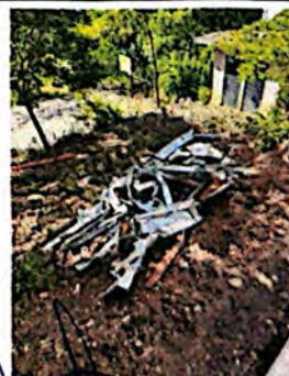
Foto 6: Retiro de canal pluvial en malas condiciones.
