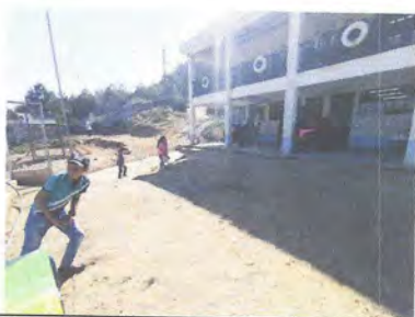
Foto 9: PATIO DE TIERRA CON DESNIVEL PRONUNCIADO
