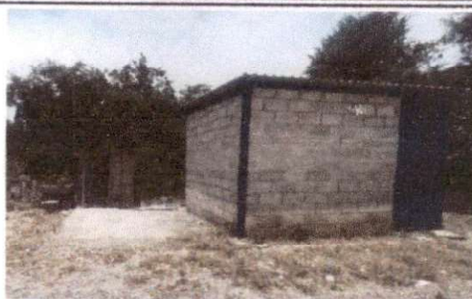
Foto 8: Cernido en paredes exteriores de cocina.
