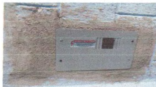
Foto 2: Caja y flípones principales nueva instalación finalizada.
